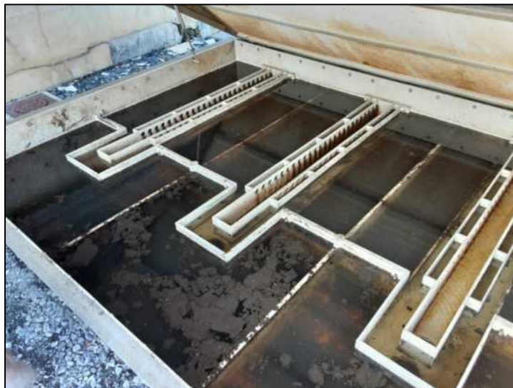
Station de traitement des eaux usées de type disques biologiques (Altereo – Novembre 2020)
