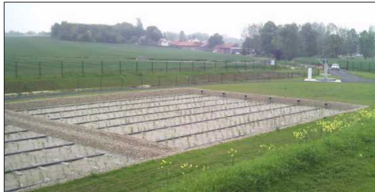
Station de traitement des eaux usées de type filtres plantés de roseaux (Altereo – Mai 2012)
